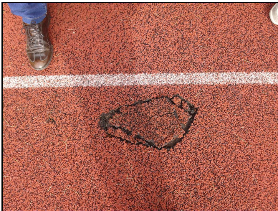
Dettaglio di una porzione di manto distaccata (foto n. 12)
