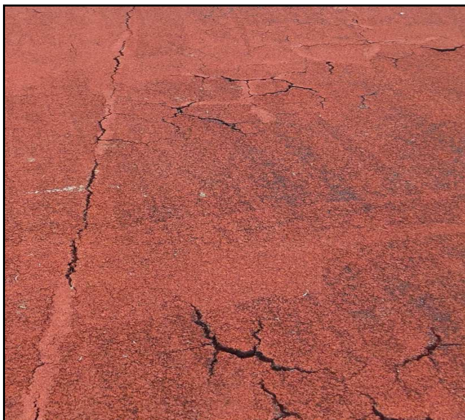
Dettaglio manto dell'area salto in alto - fessurazioni e giunti aperti (foto n. 20)
