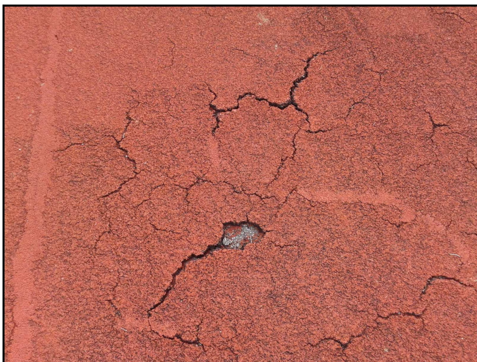
Dettaglio manto dell'area salto in alto - fessurazioni profonde e distacchi (foto n. 18)
