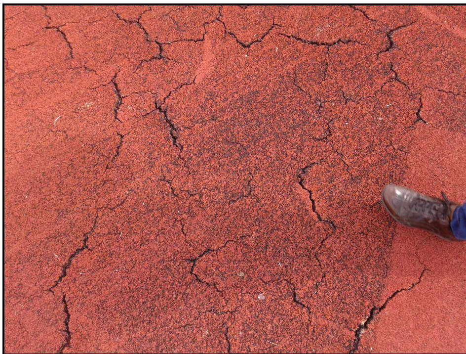
Dettaglio manto dell'area salto in alto - fessurazioni profonde (foto n. 19)
