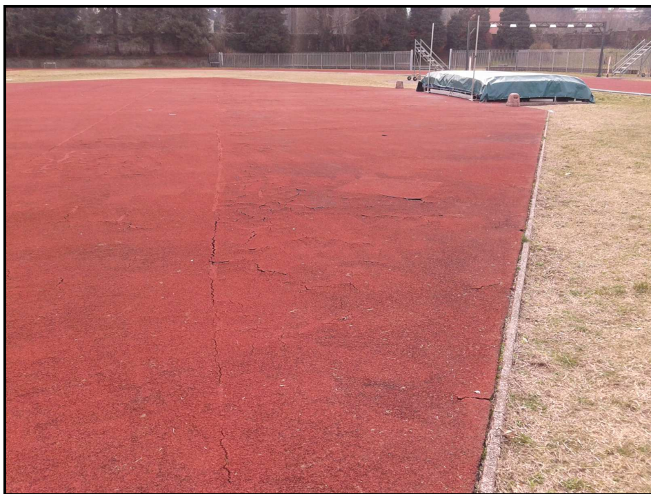
Area salto in alto lato nord – manto fessurato / giunti aperti (cono ottico n. 14)
