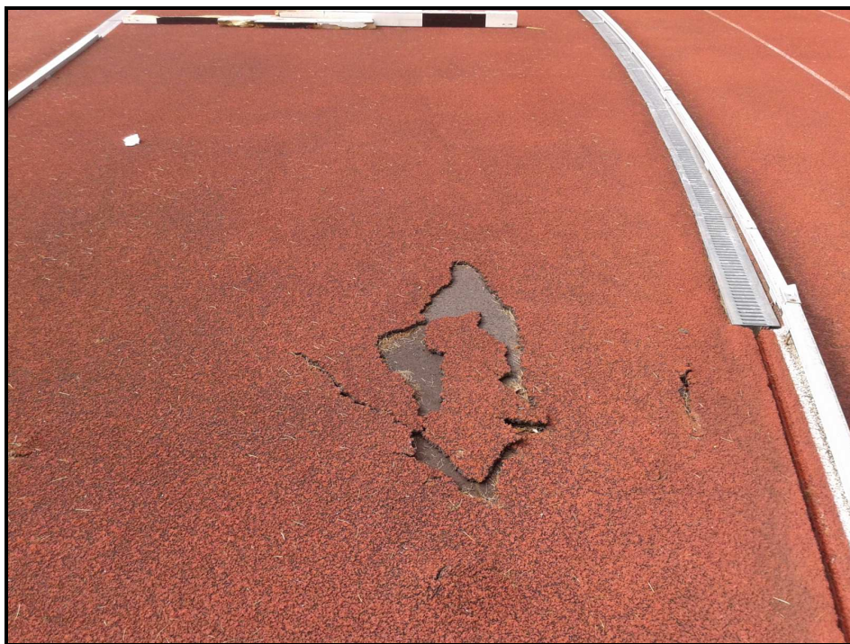
Porzione di manto distaccata (foto n. 10)
