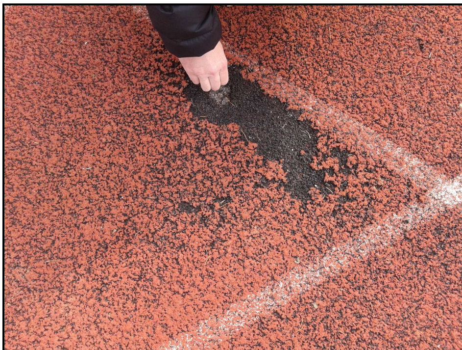
Manto sintetico usurato in prossimità della partenza (foto n. 5)
