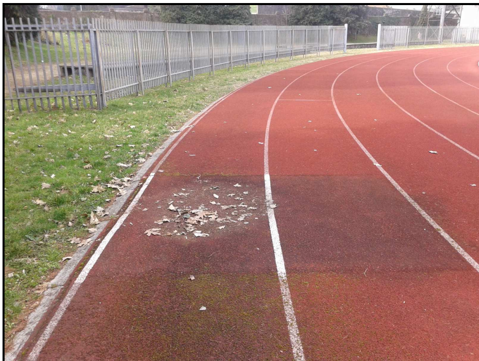
Avvallamento pista lato sud est (cono ottico n. 24)
