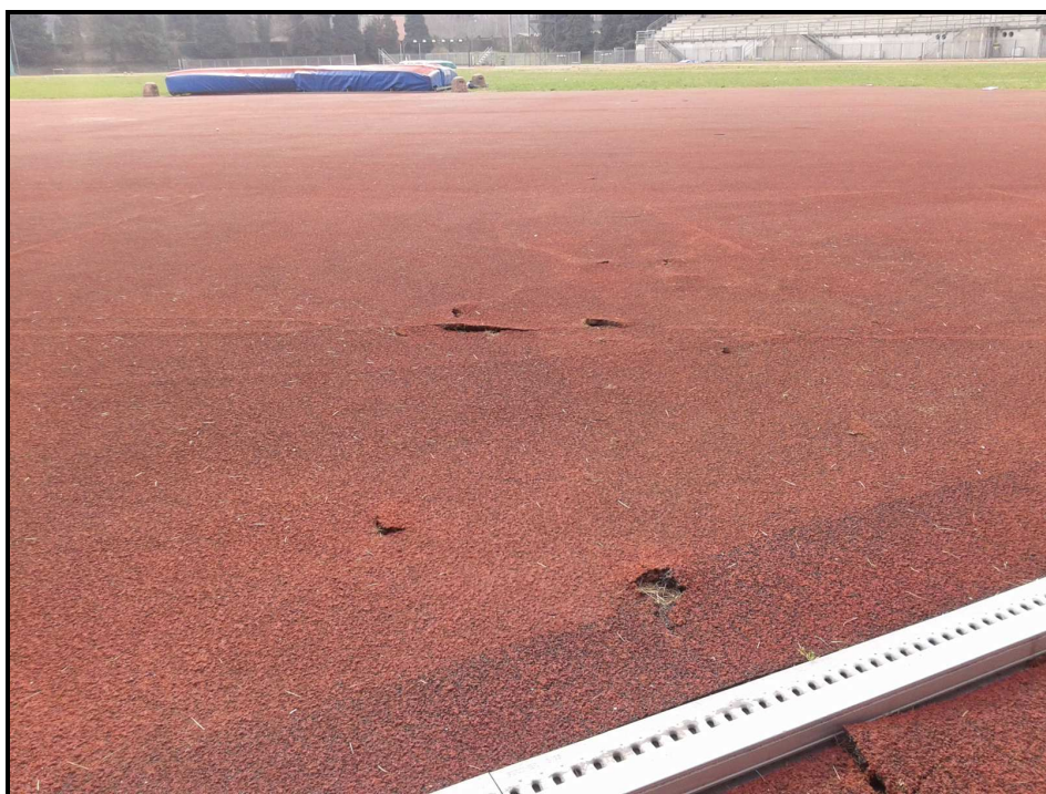
Area salto in alto lato nord – manto lesionato / distacchi (cono ottico n. 13)
